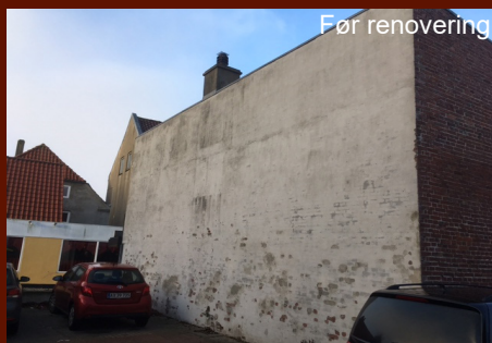
Svirrebom i Lemvig. Eksempel på opfugtet og afskallende murværk, som fremstår skæmmende
